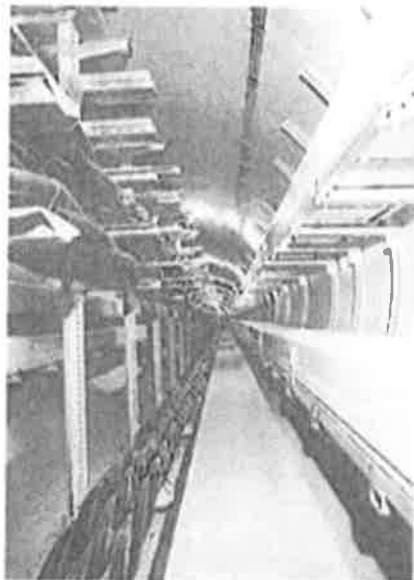
▲洞道（地下トンネル）を通過して、27万5千ボルトの電気が高輪変電所に送られる
