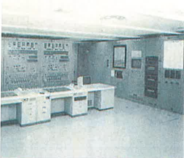
制御室ではコンピュータによって変電所全体を24時間監視制御している
